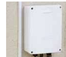
Armoire de commande
